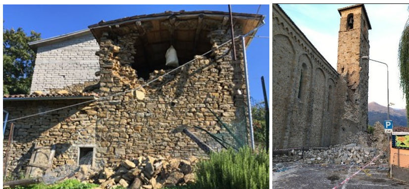
Figura 2.1. Collasso di strutture murarie a causa della scarsa qualità muraria.
