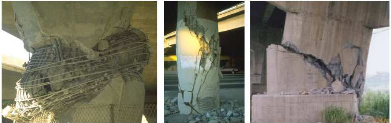
Figura 2-3 – Danni su pile per taglio e presso-flessione
