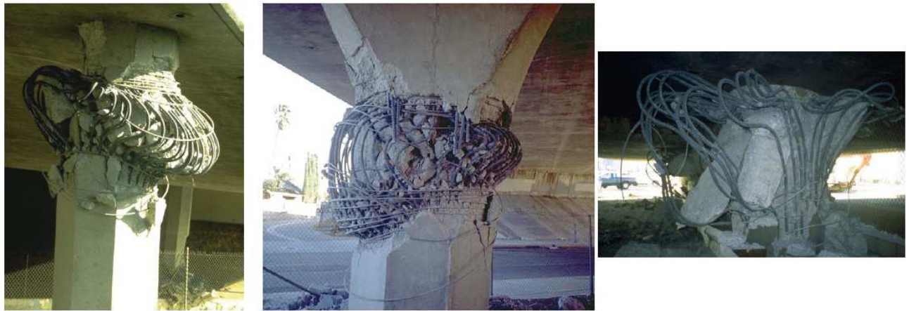
Figura 2-1 – Danni strutturali alle pile con la formazione delle cerniere plastiche
