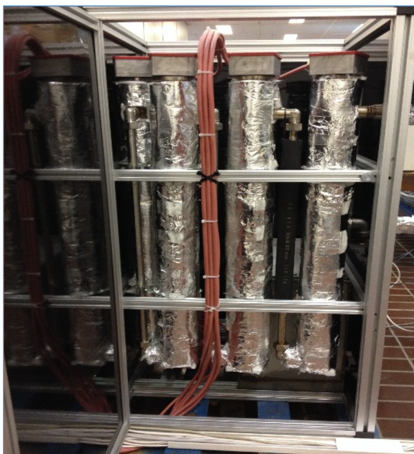
Fig. 44 - Particolare del termoregolatore ad olio diatermico: coibentazione delle scaldiglie
