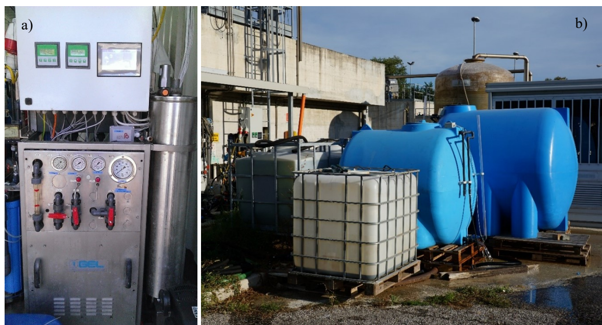
Figura 26 Installazione del pilota RO DT (a) e dei serbatoi di accumulo (b) nella piattaforma trattamento rifiuti liquidi di Falconara
