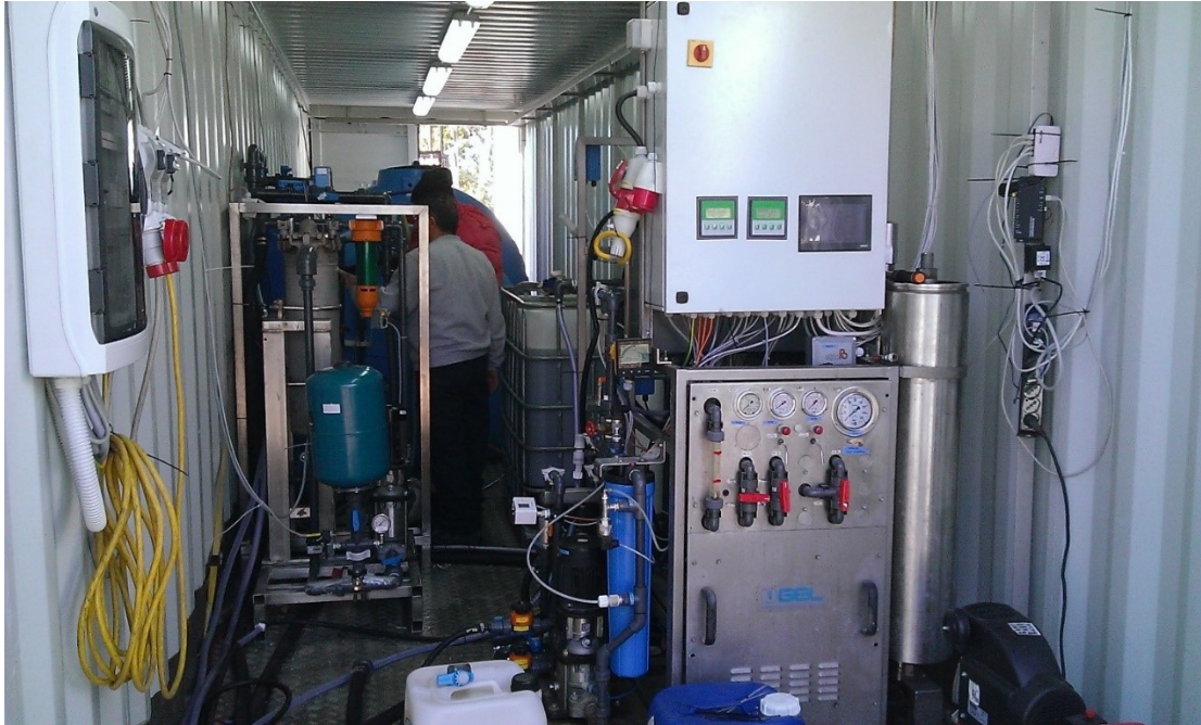
Figura 29 Impianto pilota RODT su container scarrabile
