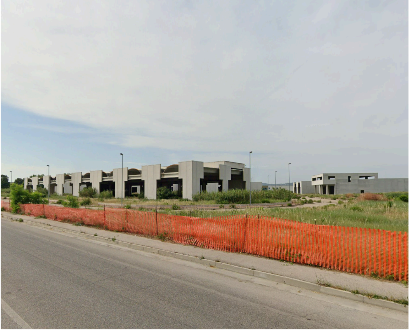
Fig. 17. Capannoni industriali incompiuti da più di vent'anni in zona industriale Brancadoro, Sant'Elpidio a Mare (FM)
