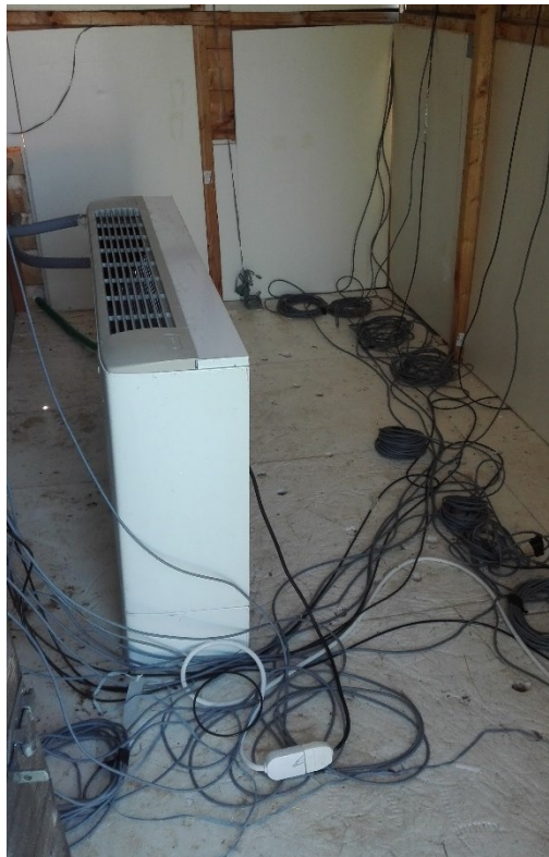
Fig. 110 – Sistema di raffreddamento all'interno della serra: ventilconvettore.
