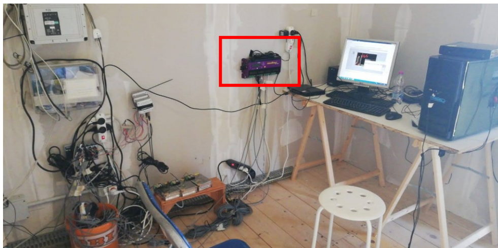
Fig. 103 – Strumentazione di controllo, registrazione e monitoraggio dei dati: in evidenza il DataTaker DT500 interno alla struttura in muratura adiacente al mock up in legno esposto a Sud.
