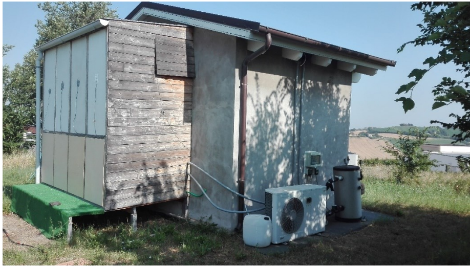
Fig. 109 – Sistema di raffreddamento: pompa di calore.
