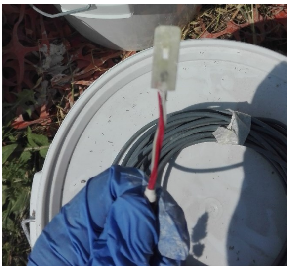
Fig. 51 – Termoresistenza PT100, prima dell'installazione sulla facciata esterna del mock up.
