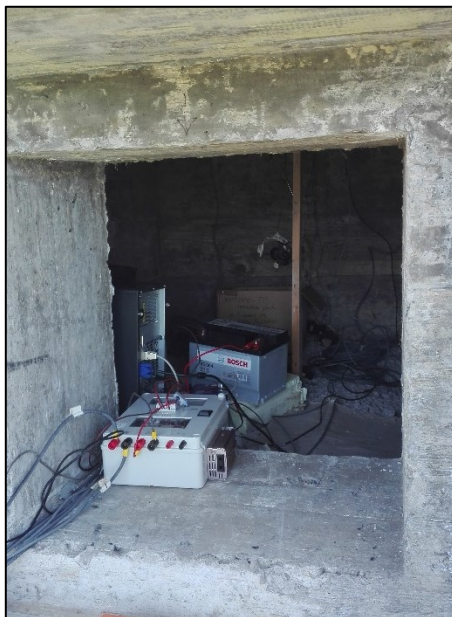
Fig. 57 – Collegamento con l'alimentazione ed il sistema di acquisizione e memorizzazione dati.
