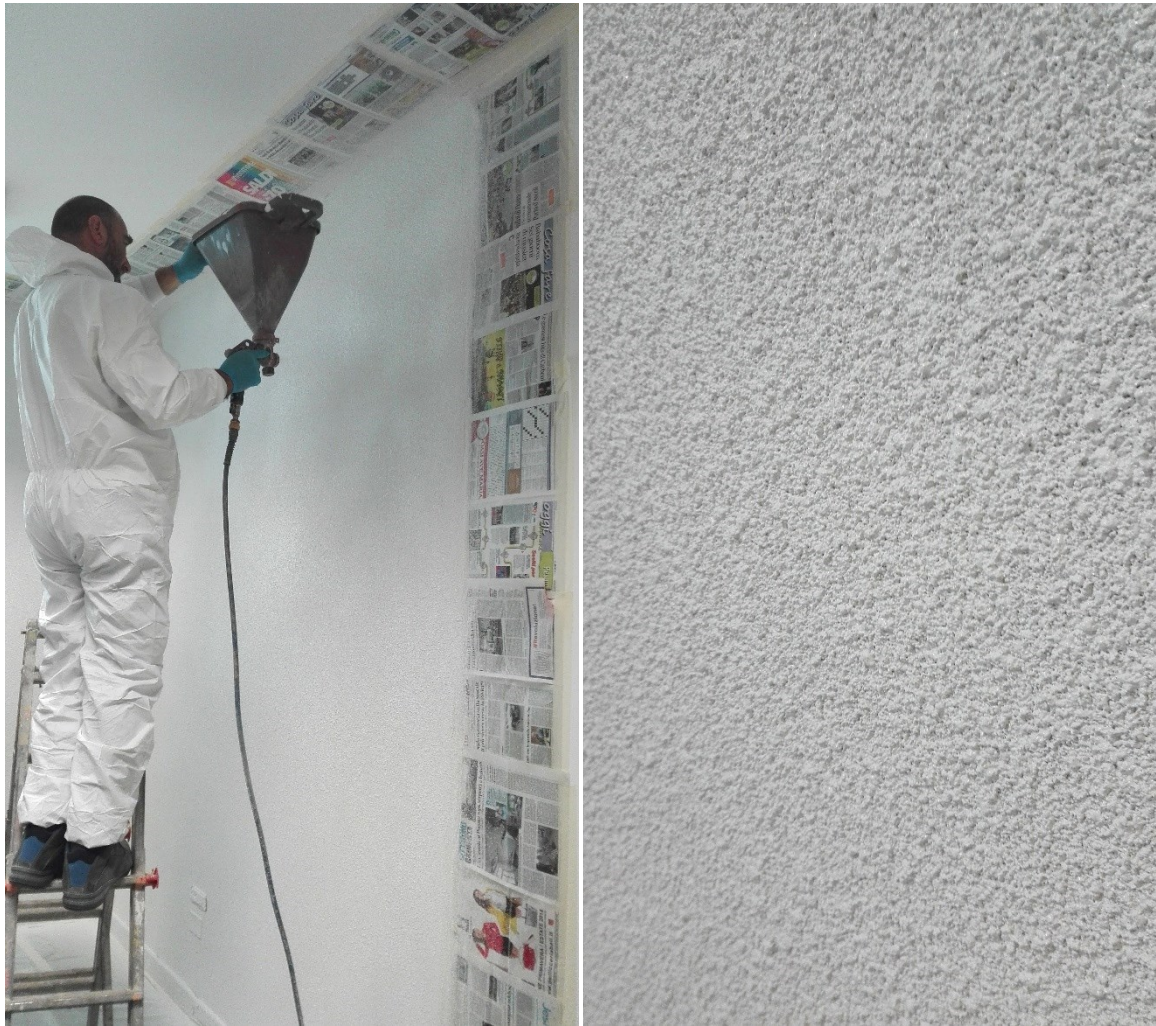
Fig. 91 - Applicazione della pittura in sughero con sfere riflettenti P3 su una parete interna precedentemente preparata con un fissativo idoneo alla successiva applicazione del rivestimento. Obiettivo: valutare l'applicabilità e lavorabilità del prodotto, grado di finitura finale e comfort termico interno (sensazione di soft touch e parete "calda").
