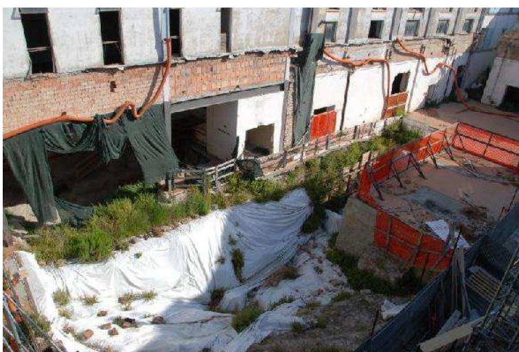
L'attuale stato di degrado del teatro romano
