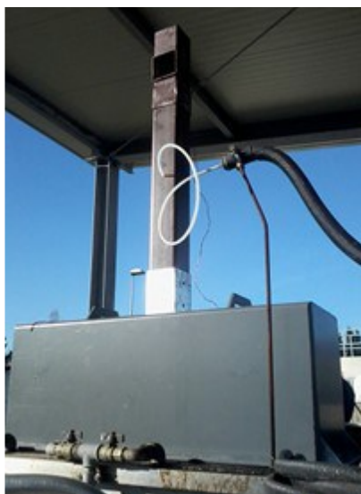
Figura 3.25 Copertura, camino e linea di captazione delle emissioni gassose.
