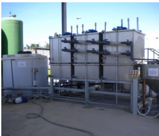
Figura 3.5 Serbatoio stoccaggio influente e reattore biologico.
